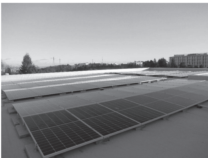
▲図書館屋上の太陽光パネル
