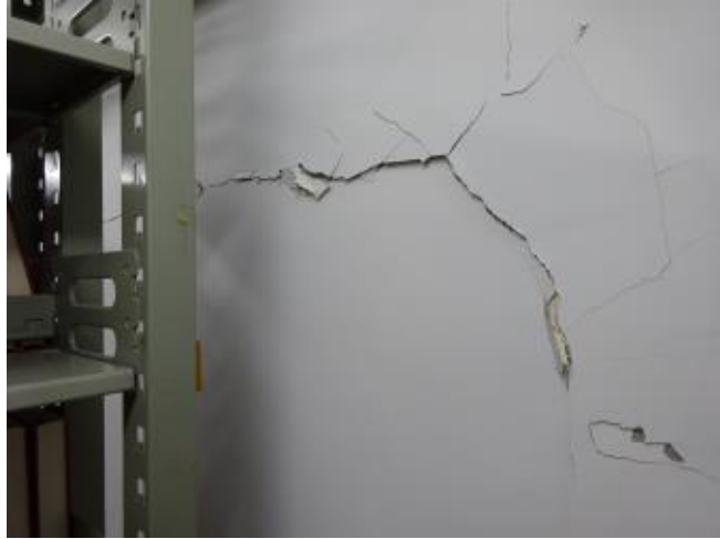
中央図書館分室 3 階書庫・壁ひび割れ
