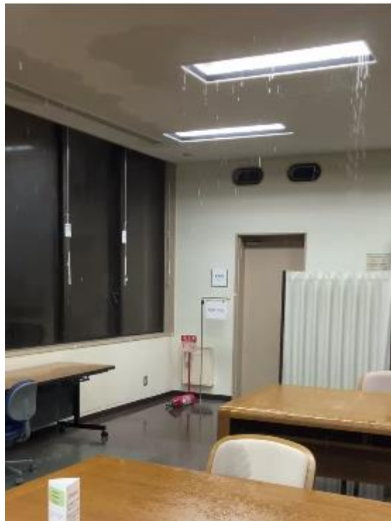
本館 2 号館 漏水
