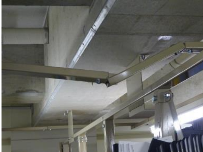
中央図書館 M4 階書庫・書架固定バー破損
