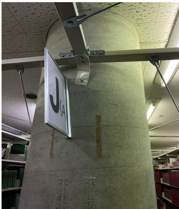
書架転倒防止用鉄骨のねじれ
