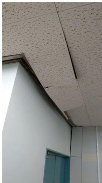
天井の損壊 (2 階)
