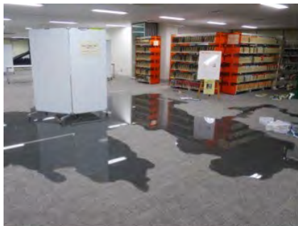
本館 グローバル学習室 天井からの漏水
