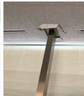
農学分館 天井破損
