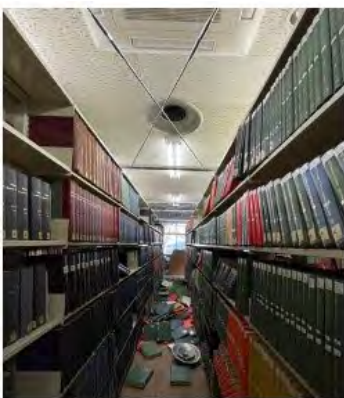
工学分館 排風口 落下
