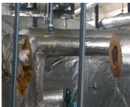
本館 機械室 空調機の配管切断 (漏水発生の一因)
