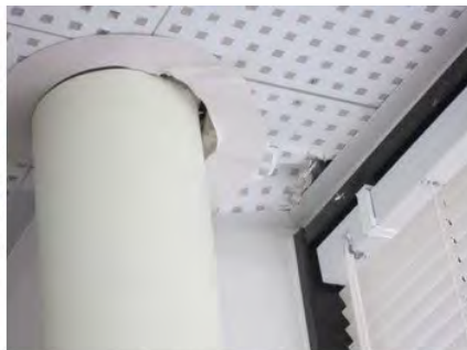
医学分館 天井破損
