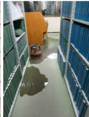
北青葉山分館 漏水
