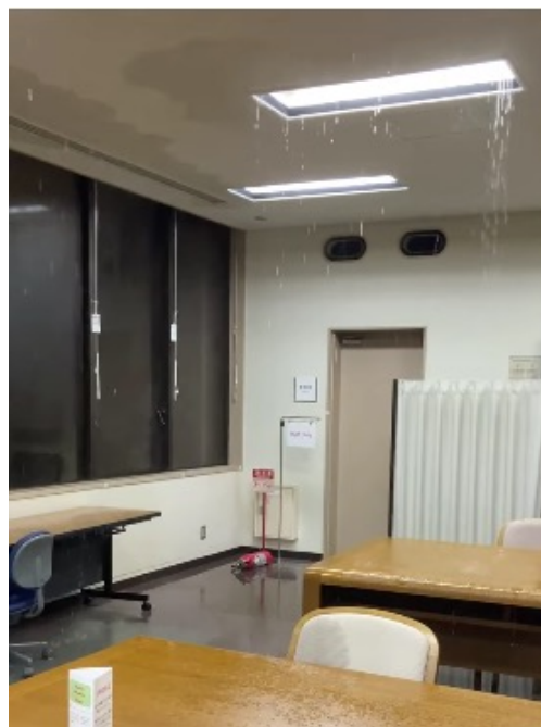
本館2号館 漏水
