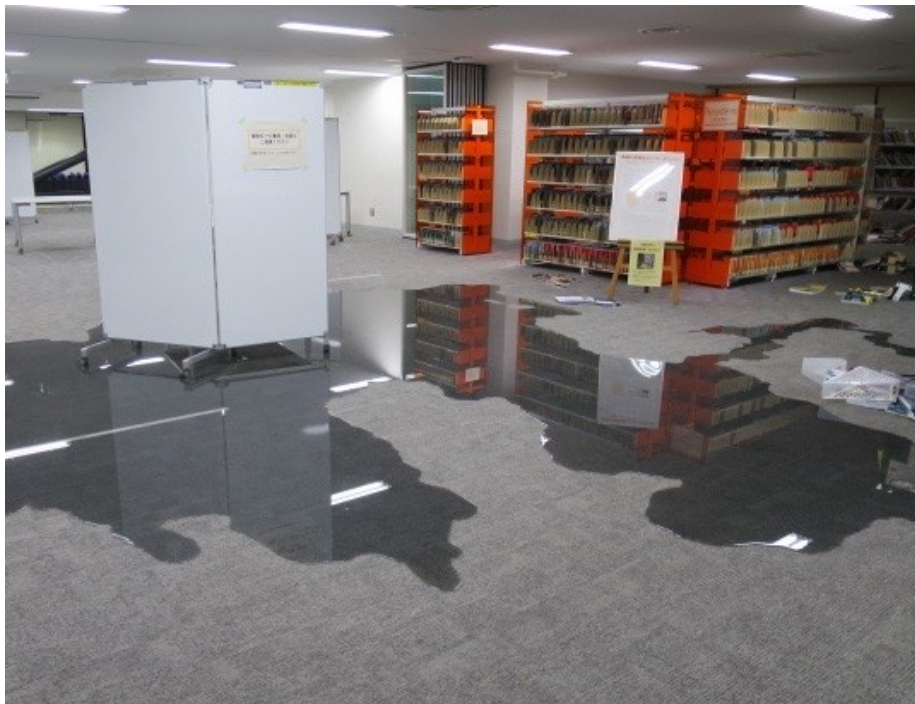
本館 グローバル学習室 天井からの漏水
