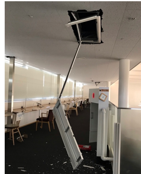
農学分館 空調機の落下
